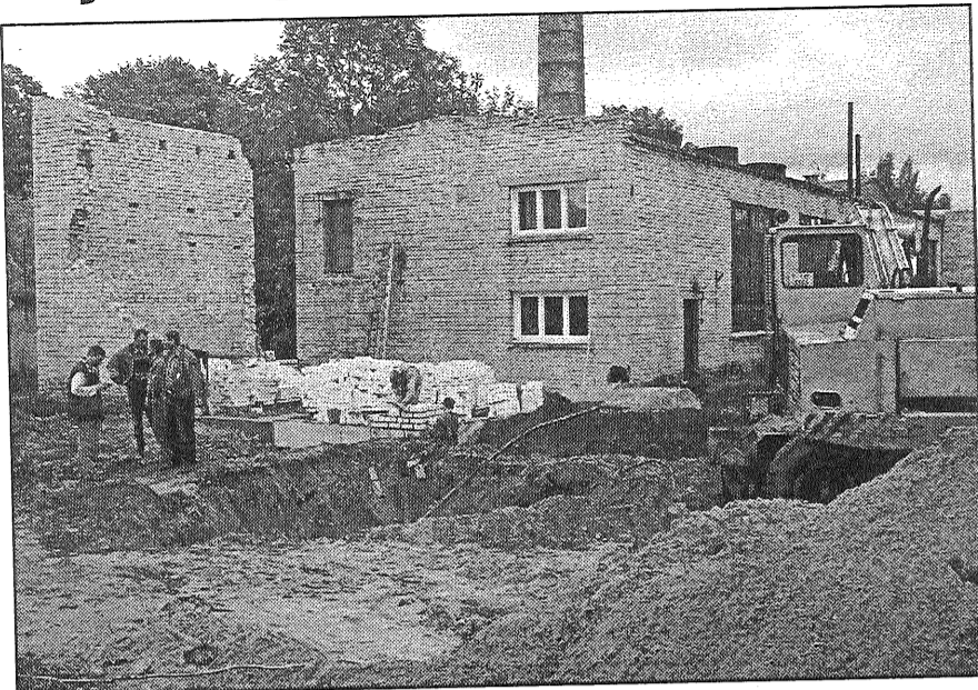
● Centrālās katlu mājas Liepu ielā 2 piebūves celtniecību veic SIA SAU «Preiļi». Foto: M. Rukosujevs
