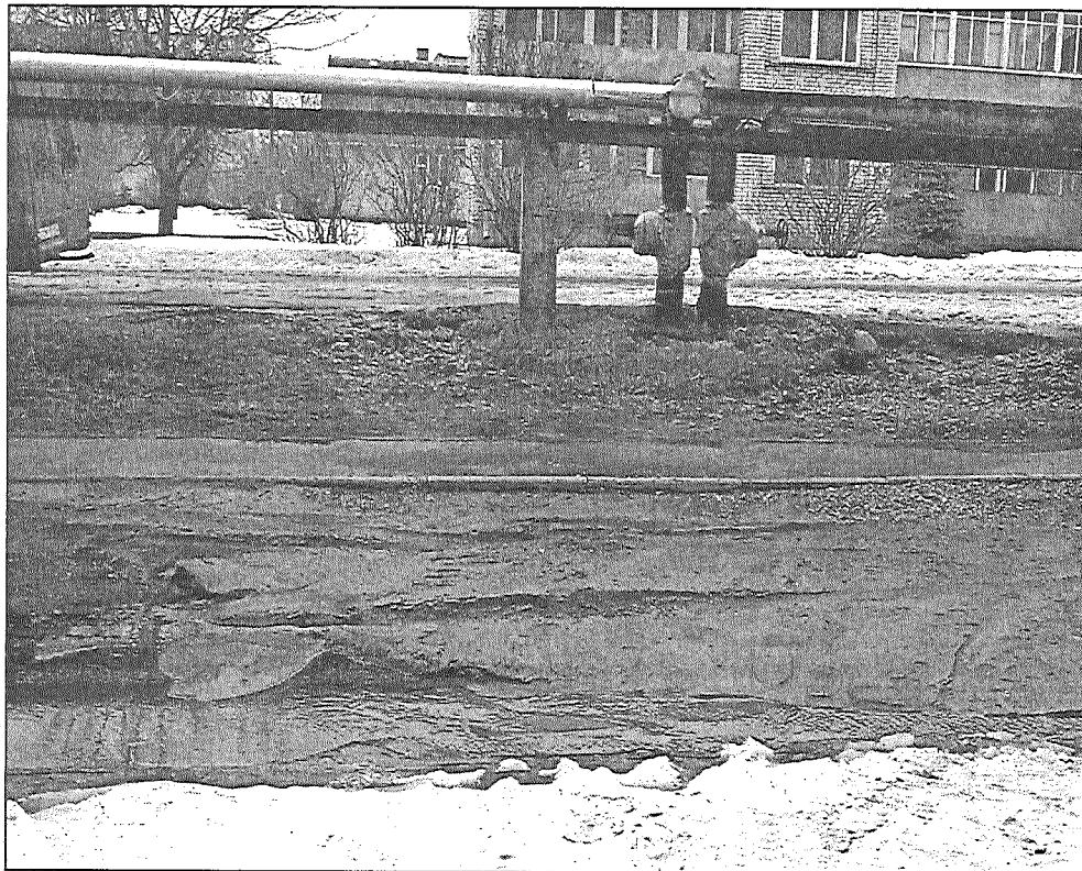
● 5. februāra rītā par nakts notikumiem ūdensvada bojājuma vietā Preiļos, A.Upīša ielā, liecināja tikai atkausētā un pamatīgi izskalotā zeme. Karstā ūdens zudumu varēja būt arī mazāk, ja «pasta balodiši» prastos lidot ātrāk. Foto: M.Rukosujevs
