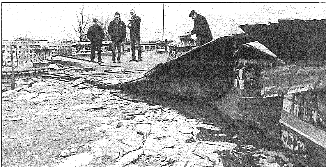
● Līvānu novada domes un 1. vidusskolas pārstāvji aplūko vētras radītos postījumus uz Līvānu 1. vidusskolas jumta.
