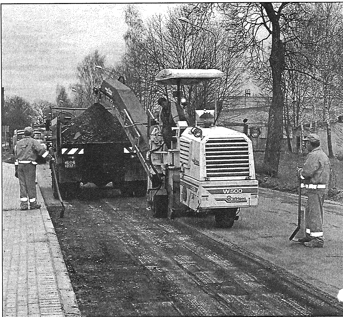
● Remondarbi jau sākušies Daugavpils ielā, kur SIA «Daugavpils ceļdaris» speciālisti izņem veco asfalta segumu un sagatavo ceļa pamatni jauna asfalta ieklāšanai.
