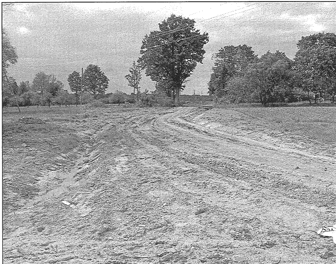
● Turpinās ceļa būvdarbi Vārkavas novadā. Jaunuzbūvētais ceļa posms radīs ērtākas pārvietošanās apstākļus Zūsinu iedzīvotājiem.
