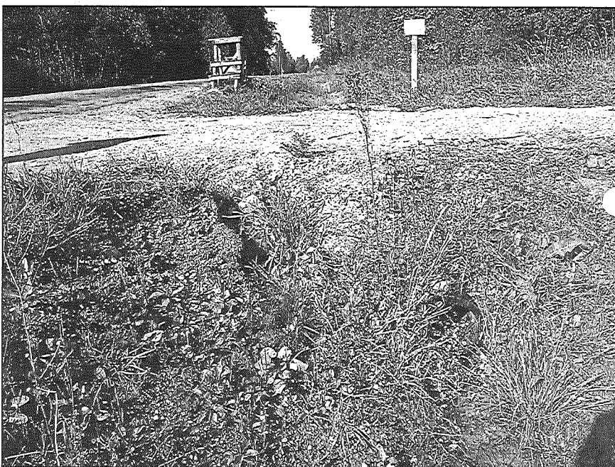
● Ja jau pāris vasaras mēnešu laikā lietus notekūdeņi ir tā izskalojuši caurtekas malas, varam iedomāties, ka drīzajās rudens lietavās posta darbi būs nopietnāki. Redzams, ka darbs izdarīts pa roku galam. Foto: A.Dz.
