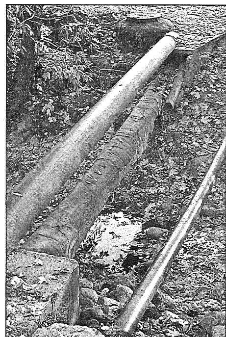
● Siltumtrases pārvads pāri upītei Mehanicatoru ielā pērnziem sildīja visu masīva runču nosalušās ķepas. Vai šoziem atkārtodiet tas pats?
