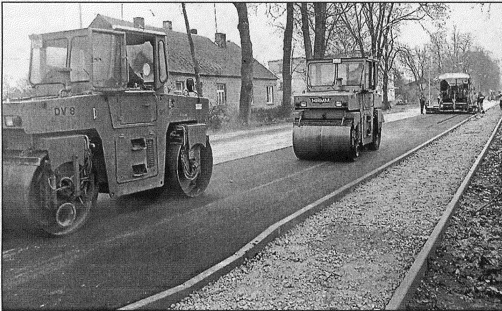
● Preiļos pēc ūdensvada un kanalizācijas sistēmas būvdarbiem, kas tika īstenoti par ES Kohēzijas fonda finansējumu, beidzot sagaidīts jaunais asfalta segums daļā no Daugavpils ielas. Tomēr satiksme visā ielas garumā pilnībā tiks atjaunota tikai nākamā gada pavasarī. Atbilstoši līgumam darbi jāpabeidz 31. maijā. Foto: A.Dzerkalis
