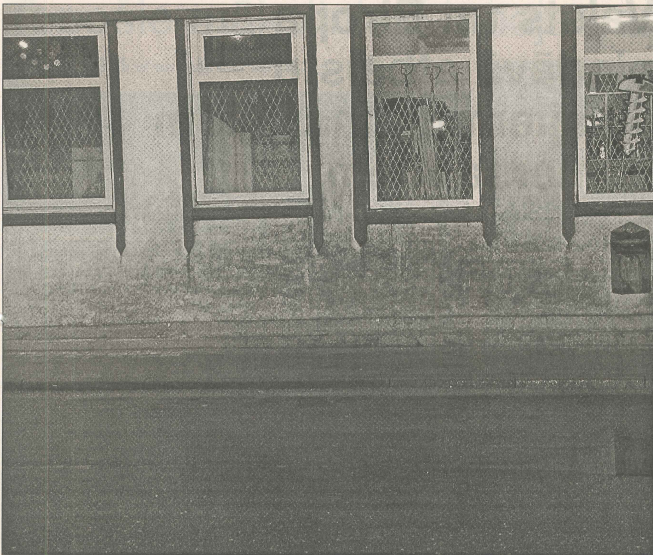
● Šīs ēkas uz Brīvības un Valmieras ielu stūra Preiļos siena ir spilgts piemērs tam, kādu postu mājas pamatiem un sienām nodara pa ziemu uz ielām kaisītais sāls kombinācijā ar notekūdeņiem. Īpašniekam atliek tikai viens – no gada gadā remontēt un pārkārtot. Foto: A.Dzerkalis
