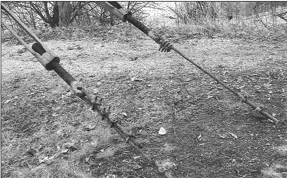
● Cilvēku noziedzīgas rīcības dēļ Stikānu — Kalvānu gājēju tilta trosēm sabojāti stiprinājumi.
