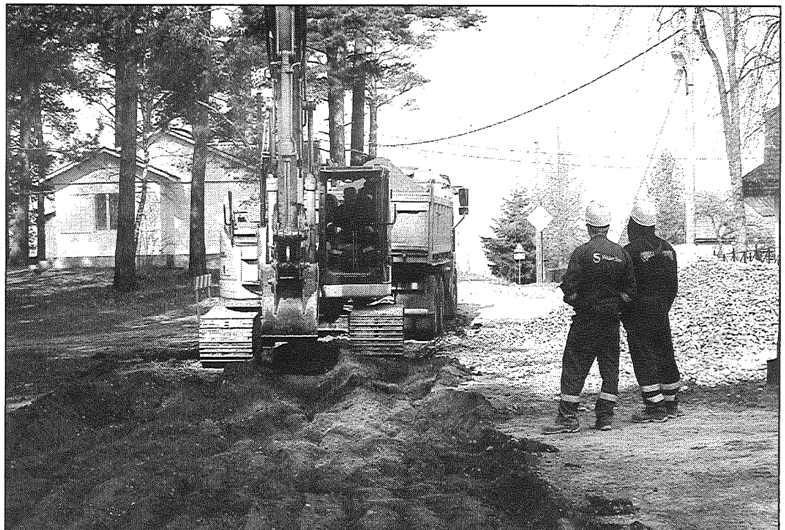
● Ir cerības, ka Aglonā ūdensvada un kanalizācijas sistēmu būvdarbu pirmā kārta varētu noslēgties jau vasaras vidū. Papilddarbi turpināsies līdz šī gada beigām. Ūdenssaimniecības sakārtošanā Aglonas ciematā kopumā tiks ieguldīts aptuveni pusmiljons latu. Foto: A.Šņepsts
