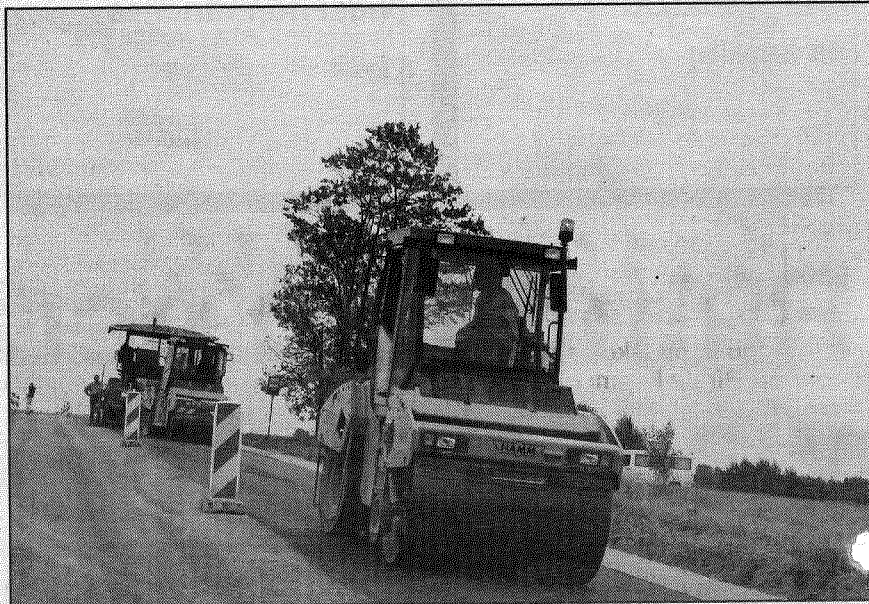
● Jau oktobrī ekspluatācijā tiks nodots par Eiropas Reģionālās attīstības fonda līdzekļiem rekonstruētā ceļa Krāslava — Preiļi — Madona posms no Priekuļiem līdz Priekuļiem. Pašlaik būvnieki jau klāj asfalu un steidz citus sagatavošanas darbus. Foto: A.Šņepsts
