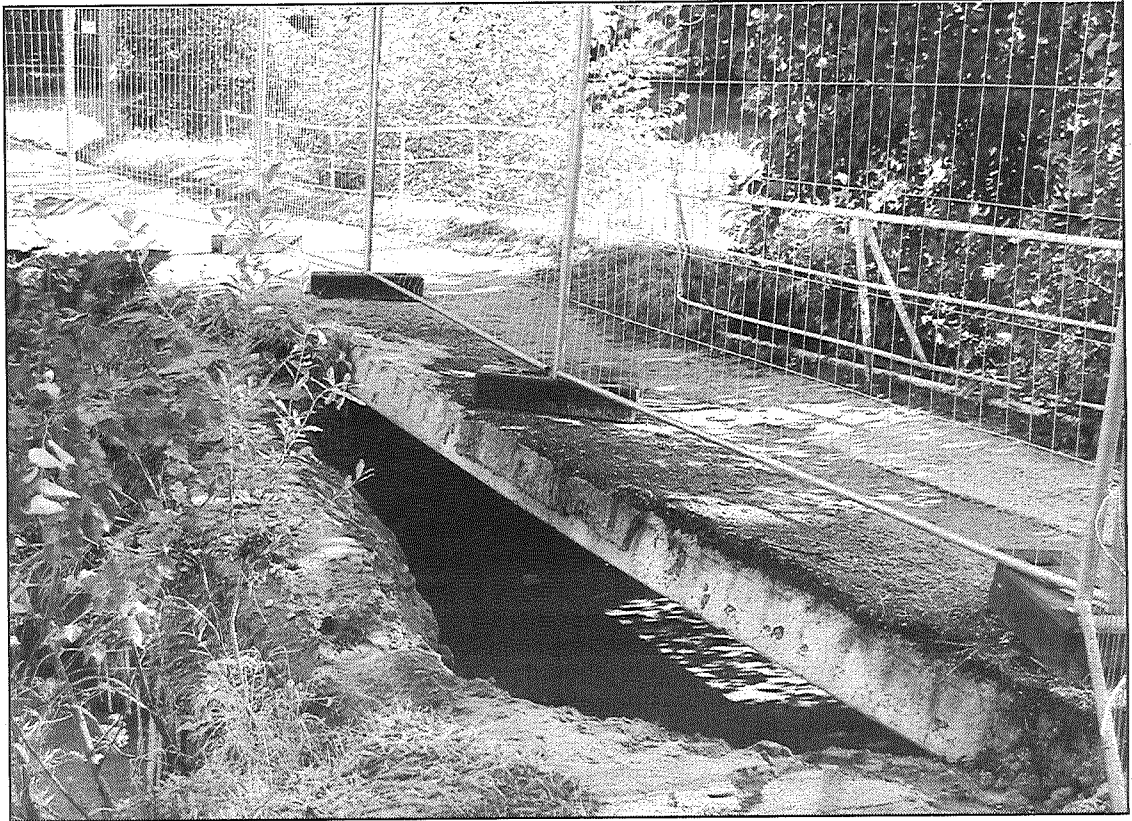
● Šī gada pavasara ūdeņi bija tik neganti un spēcīgi, ka sabojāja arī gājēju tiltiņu Preiļu parkā pie zirgu stalliem. Gājēju drošībai uz tiltiņa tika uzstādītas norobežojošas barjeras. Valsts piešķirtie līdzekļu plūdu seku novēršanai pašvaldībai dos iespēju atjaunot tiltiņu. Foto: A.Šņepsts
