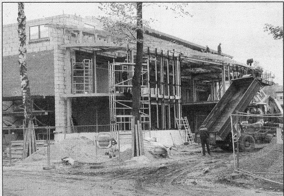
● Atjaunojamās Līvānu centrālās bibliotēkas izskats mainās katru dienu, jo celtnieki strādā raiti. Ēka tiek celta gandrīz no jauna, jo tās konstrukcijas bija pamatīgi nolietojušās.
