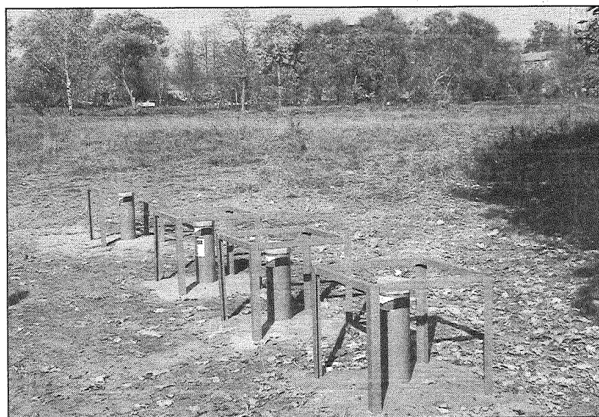
● Tā izskatās Kohēzijas fonda līdzfinansētā projekta ietvaros izveidotie četri pazemes ūdeņu kvalitātes un kvantitātes noteikšanas urbumi, kas būs aprīkoti ar automātiskajiem līmeņa mērītājiem.
