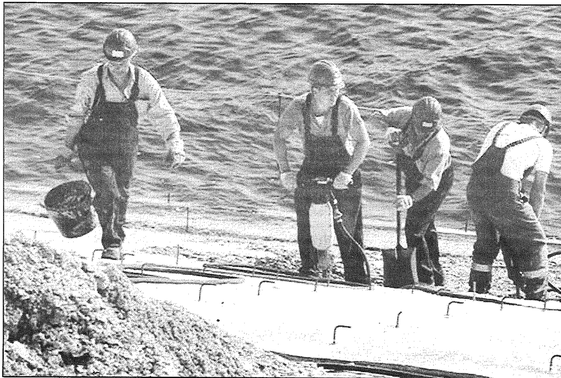
● Smags darbs. Nogāze ir stāva, tāpēc nevar izmantot tehniku. Akciju biedrības «DHB» strādnieki nokaļ bojāto betona kārtu un aiznes to projām ar rokām.
