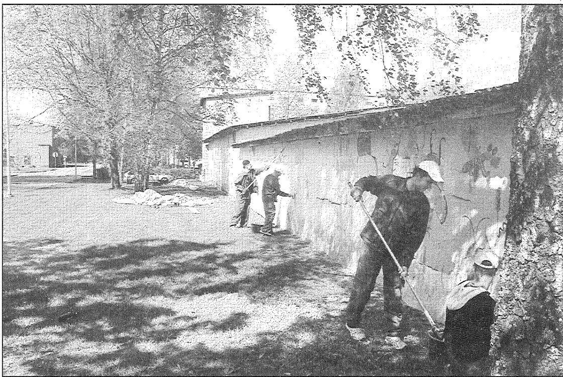
● Topošie apdares darbu speciālisti, izmantojot Preiļu novada domes sagādātos materiālus, sagatavo sienu jaunam āra gleznojumaam.
