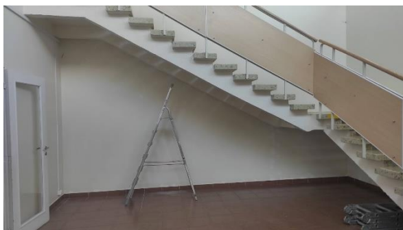
3.2.1. att. Preiļu GB foajē patrepe pirms remontdarbiem
